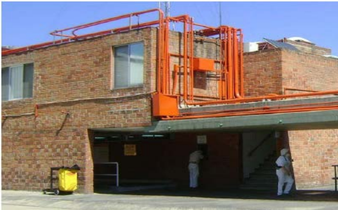
Figura A-1. Aunque este tipo estructural predomina en casa habitación, también se observa en construcciones para uso industrial
