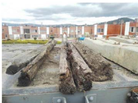
Figura 14 Pudrición del durmiente de madera
