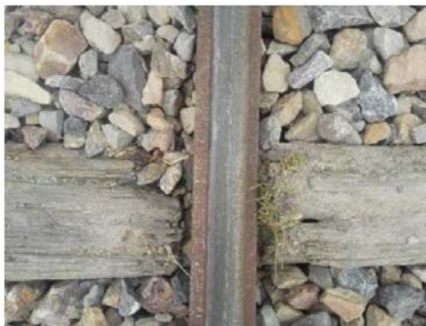
Figura 17 Rompimiento de madera
