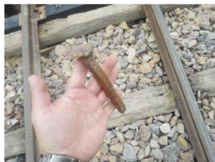
Figura 16 Defecto de no fijación en el durmiente
