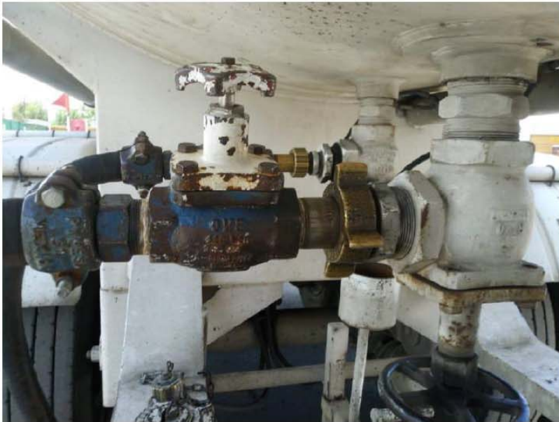
RECEPCION DE GLP DESDE EL SEMIRREMOLQUE
