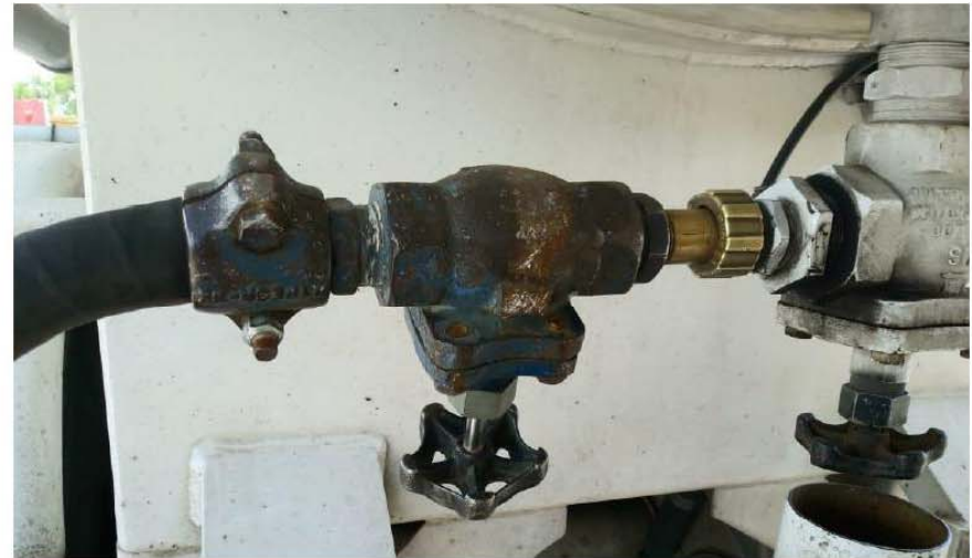
SUMINISTRO DE VAPOR AL SEMIRREMOLQUE
