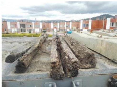
Figura 14 Pudrición del durmiente de madera
