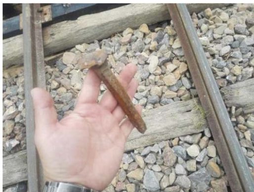
Figura 16 Defecto de no fijación en el durmiente
